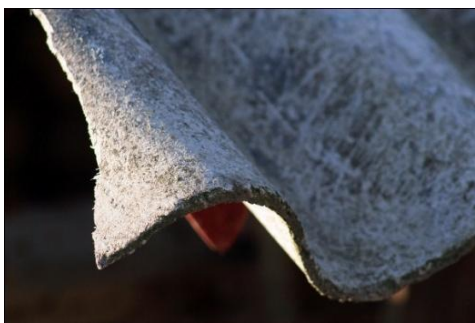
Zdjęcie 7 Płyty faliste azbestowo-cementowych
