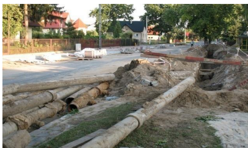
Zdjęcie 9 Rury azbestowo – cementowe
